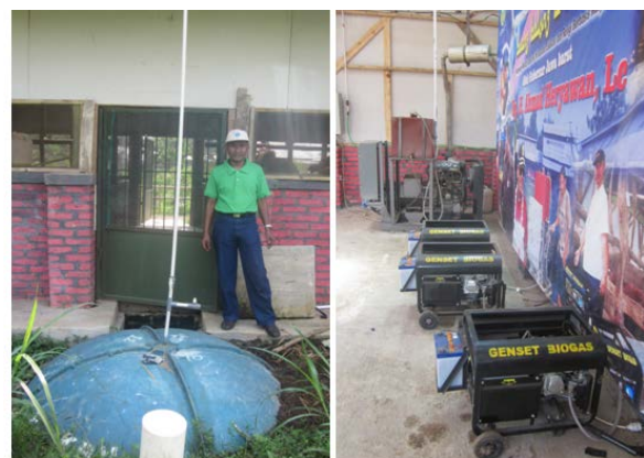
Gambar 2. Digester dan genset biogas yang terinstalasi di Pesantren Saung Balong, Majalengka.
